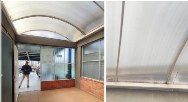
FOTO 1: Condiciones iniciales de la cubierta de la entrada del gimnasio estudiantil
