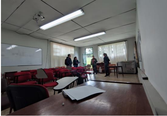
FOTO 1: Aula S-107 Pavimentos - Condición inicial
