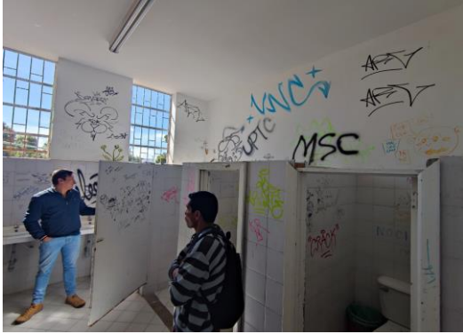
FOTO 1: Condiciones iniciales de los baños piso 1
