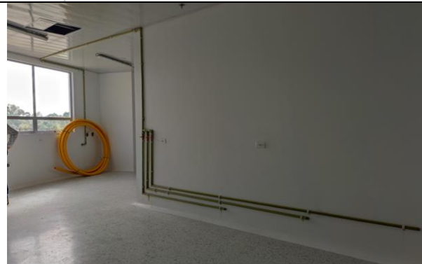
FOTO 2: Distribución de red instalada en la cocina
