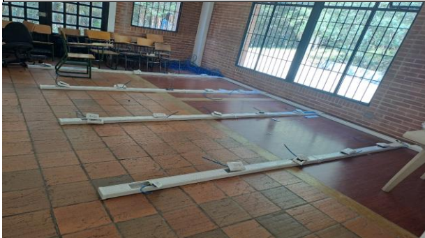
FOTO 1: Instalación de cable UTP cat 6A para 21 pto de datos en Aula Especializada Ed. Música
