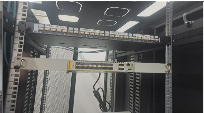
FOTO 10: Instalación Switch de 16 puertos en gabinete cuarto eléctrico 1er piso ed. de Posgrados Tunja
