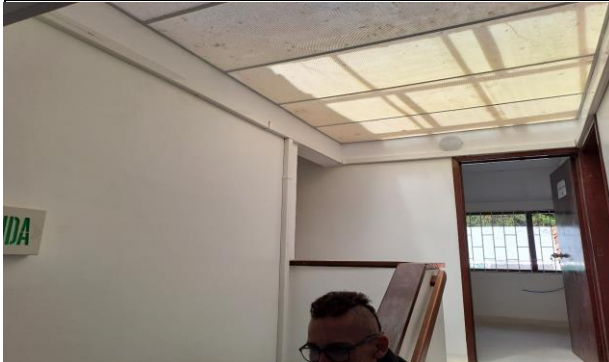
FOTO 3: Instalación canaleta plástica y cable UTP cat 6A para distribución de datos en espacios casa SIG barrio la Colina
