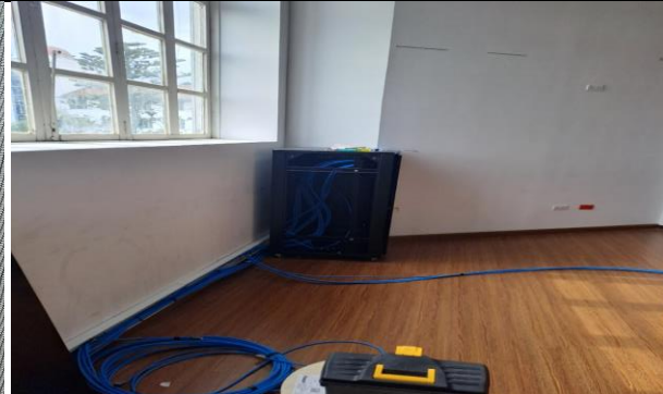
FOTO 6: Conexión cable de datos en Pach Panel 24 puertos, Idiomas aula C-201
