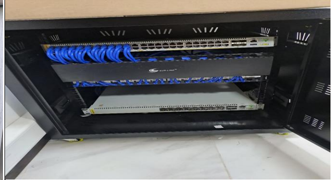
FOTO 8: IntalaciónSwitch de 24 puertos en Casa Maldonado - Tunja
