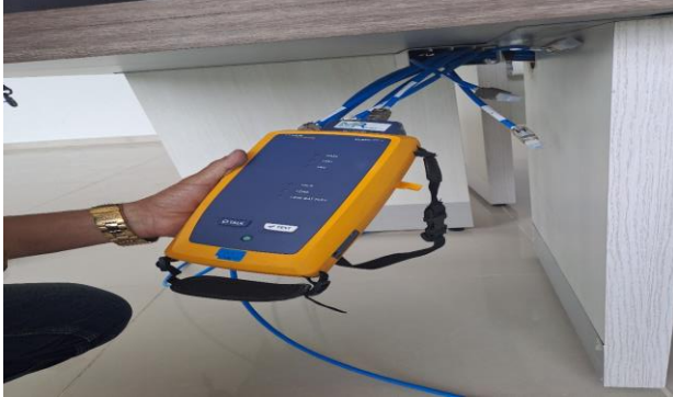
FOTO 7: Certificación pto de datos sala de juntas Rectpría Ed. de Posgrados.
