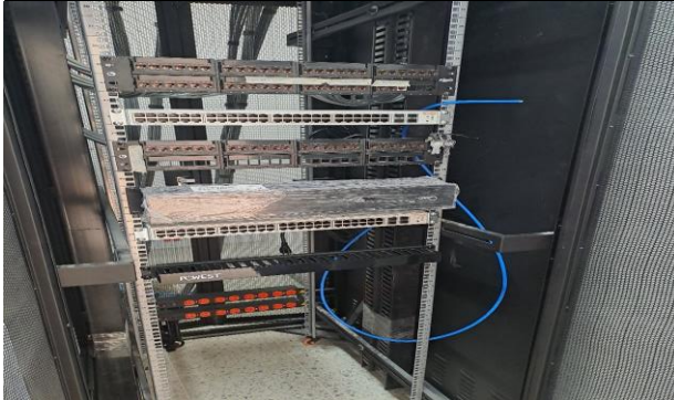
FOTO 5: Salida de datos cuarto eléctrico 4to piso para oficina Rectoría Ed. Posgrados
