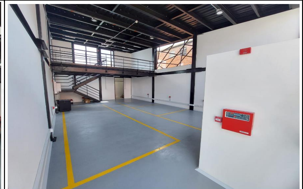
FOTO 3: Central de alarma GSM con respaldo eléctrico y pulsador
