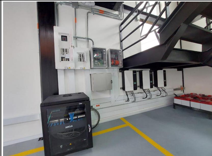
FOTO 2: Tableros y Rack de comunicaciones con switch de 24 puertos
