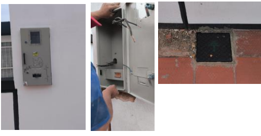
FOTO 11: Caja para contador y puesta a tierra
