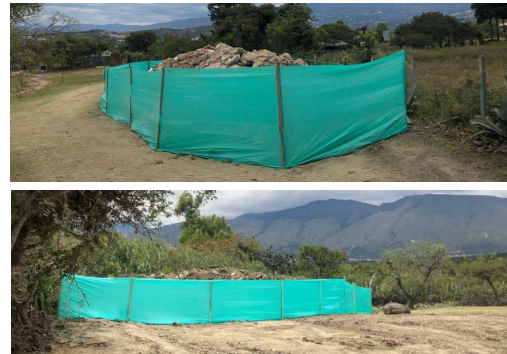
FOTO 8: Cerramiento y delimitación de las áreas donde se acopian los materiales sobrantes de excavación y demolición.
