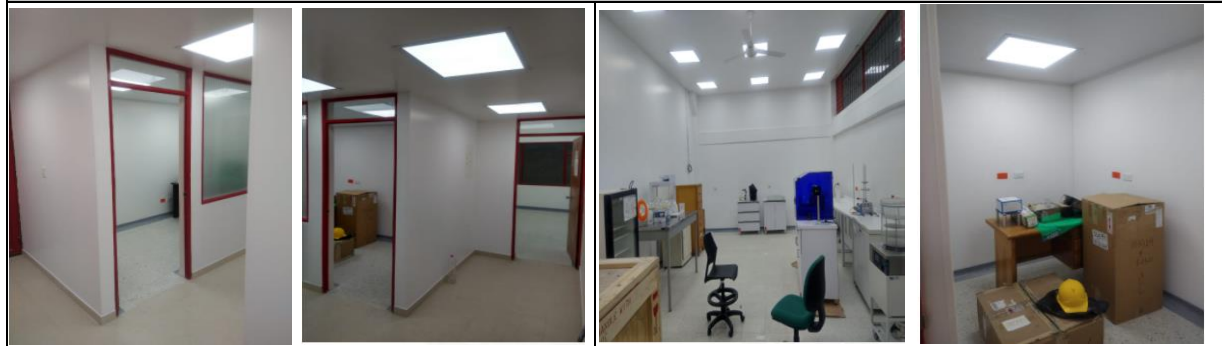
FOTO 1: ESTADO FINAL DE LA OBRA, MUROS PINTADOS, CAMBIO DE PISOS Y LUMINARIAS FOTO 2: ESTADO FINAL DEL AREA # 1 Y AREA # 2
