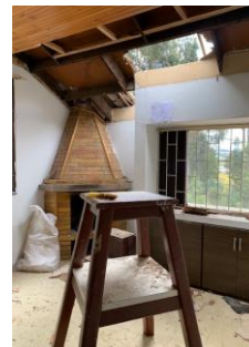
FOTO 16: CASA 1 BLOQUE 7 Apertura en cubierta por el desmonte del panel de abejas
