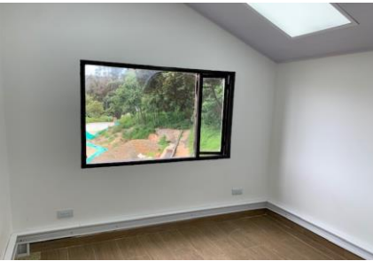
FOTO 25: CASA 3 BLOQUE 6 Cambio de ventanería por mal estado
