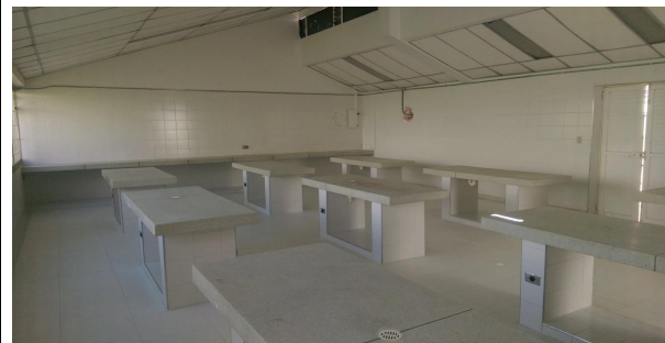
FOTO 4: Pintura epóxica para muros, incluye andamio, mano de obra, herramienta y demas elementos y actividades necesarias para ejecución. (Parte superior del enchape)
