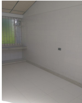
FOTO 5: Enchape de muros en baldosa cerámica (formato 20 x 20, color blanco), incluye boquilla, material de pega, mano de obra, herramienta y demas demas necesarios para la ejecución. Altura promedio 2,30 m
