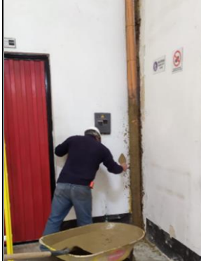
FOTO 15: Pañete sobre bajantes con filos y dilataciones
