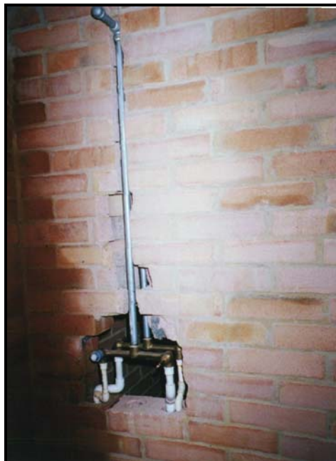
Foto 216. Regatas en muro para instalaciones de la ducha
