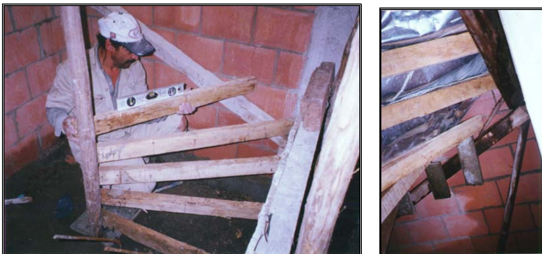
Fotos 260-261 Configuración apoyos tramo curvo, repisas y lámina
