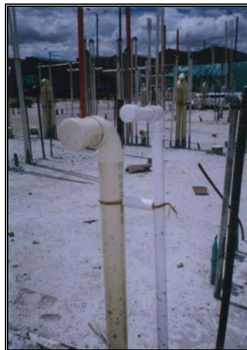
Foto 347 Tuberías sanitarias y de suministro con tapón
