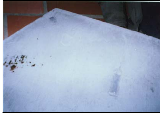
Foto 283 Lámina metálica embebida superficialmente en escalón prefabricado
