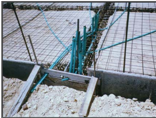
Foto 327 Concentración excesiva de tuberías conduit en vigas de cim.
