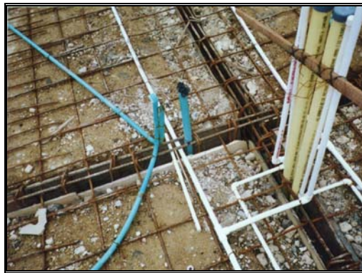
Foto 346 tuberías y accesorios.
