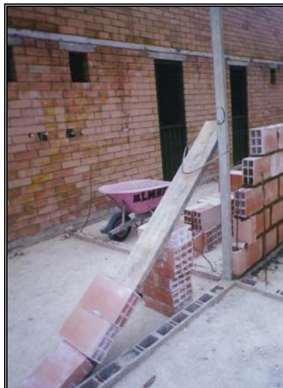
Foto 208. Apoyos típicos para guía en obra
