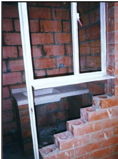
Foto 364 Problemas por mala construcción del muro
