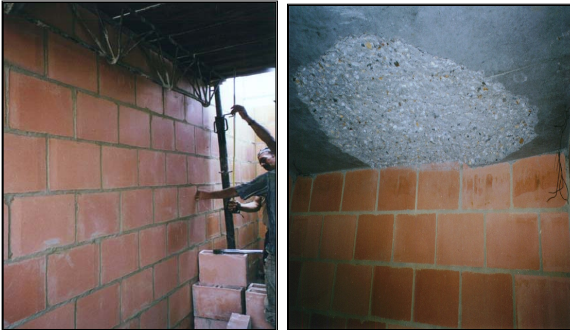
Foto 224. Aseguramiento nivel del apoyo- Placa mal fundida por flectación de la cama
