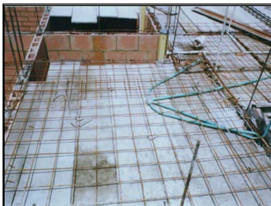
Foto 354 Tubería conduit embebida en placa de entrepiso
